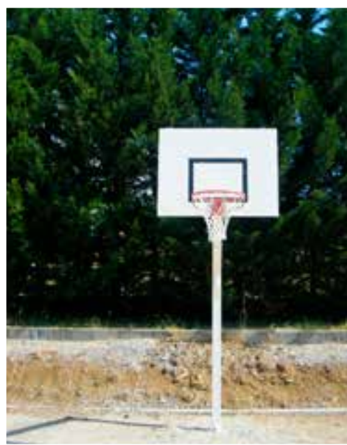
Installation d'un panier de basket (aux normes sportives et sécuritaires) dans le terrain de sport de l'école
